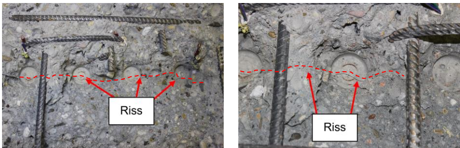
Abb. 3.23: Kontrolle der induzierten Risse nach Versuchsende – B1-N2
