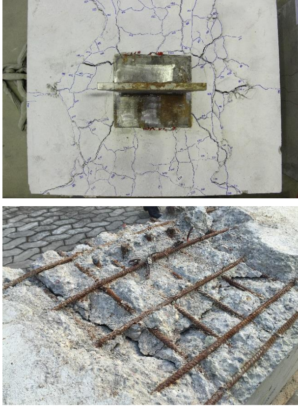
Abb. 3.50: sukzessives Absprengen der Bewehrungsüberdeckung nach Höchstlast – R5-2N
