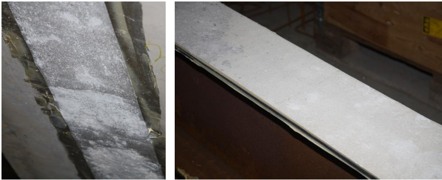
Abbildung 4-27: (links) Betonoberfläche im Auflagerbereich H, (rechts) Stahlträger im Auflagerbereich H
