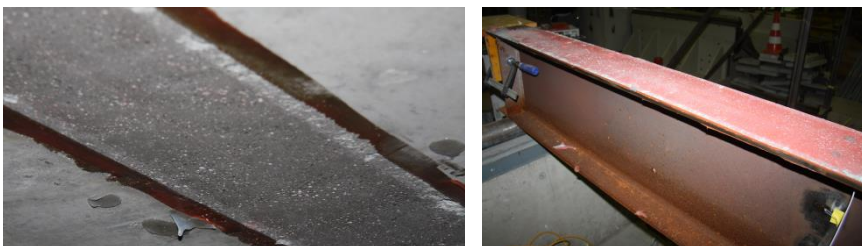
Abbildung 4-23: (links) Betonoberfläche im Auflagerbereich V, (rechts) Stahlträger im Auflagerbereich V
