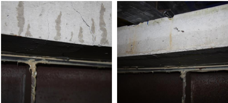
Abbildung 4-25: (links) Riss an der Lasteinleitung V, (rechts) Riss an der Lasteinleitung H
