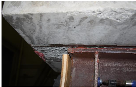
Abbildung 4-22: Überstehende Betonplatte am Auflager
