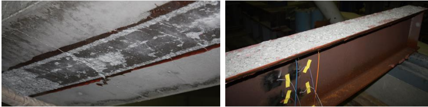
Abbildung 4-24: (links) Betonoberfläche im Auflagerbereich H, (rechts) Stahlträger im Auflagerbereich H
