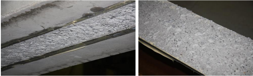
Abbildung 4-26: (links) Betonoberfläche im Auflagerbereich V, (rechts) Stahlträger im Auflagerbereich V
