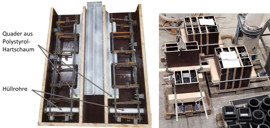
Abb. 3.3: Schalung des Probekörpers PO_06 (links) und vorbereitete Schalungen der C40 (A) - Serie (rechts)
