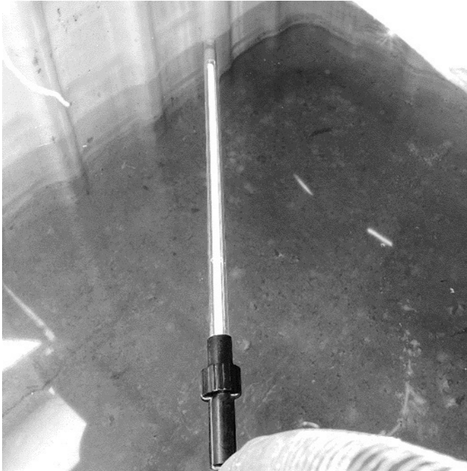
Abbildung B - 6: In den Klarwasserspeicher eingebauter UV-Tauchstrahler zur Desinfektion des aufbereiteten Wassers
