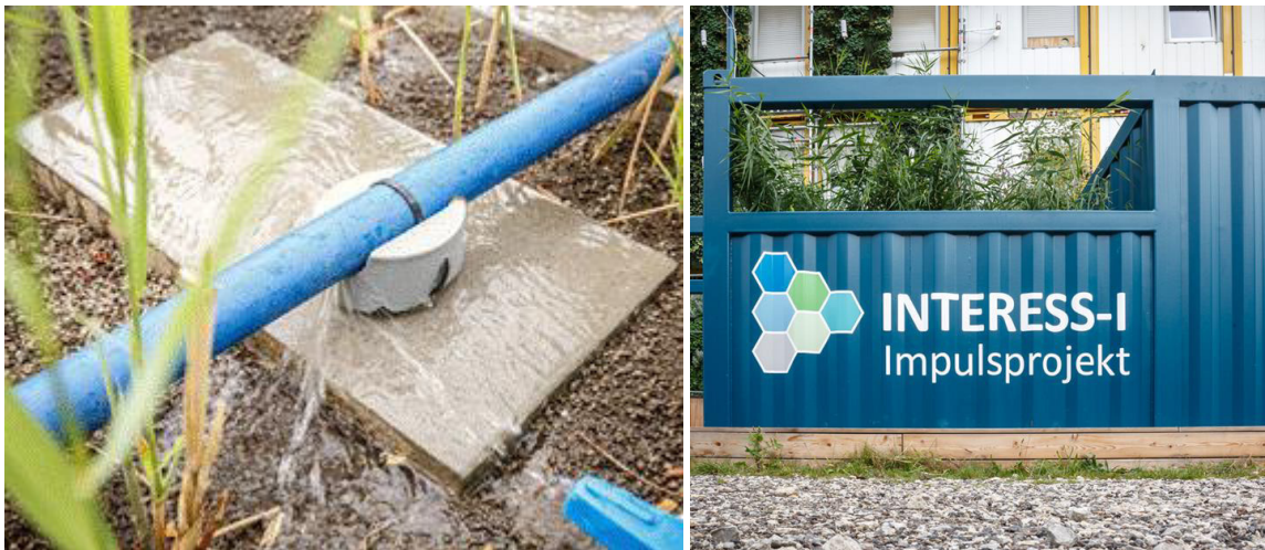
Abbildung 3-10: Beschickung des Lavasandfilters im Pilotmaßstab kurz nach dessen Inbetriebnahme mit Grauwasser (links) und Vorderansicht des aufgeständerten Vertikalfilters zur Aufbereitung von Dusch- und Handwaschbeckenabwasser (rechts). Fotos: J. Rettig (2020).
