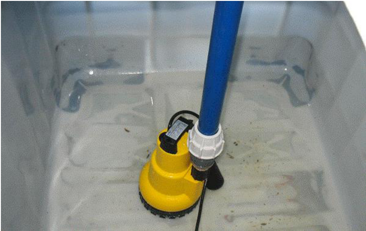
Abbildung B - 4: Bodenfilterbeschickungspumpe KSB Ama-Drainer N 301 SE im Rohgrauwassertank mit einer maximalen Förderleistung von 10 m 3 /h.
